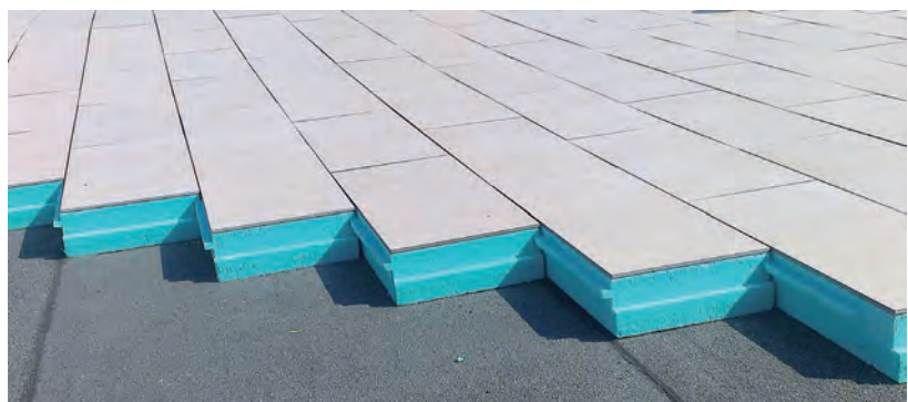
Αντεστραμμένο δώμα με σύνθετο θερμομονωτικό πλακίδιο 300X 600 mm με επικάλυψη κεραμικού πλακιδίου
